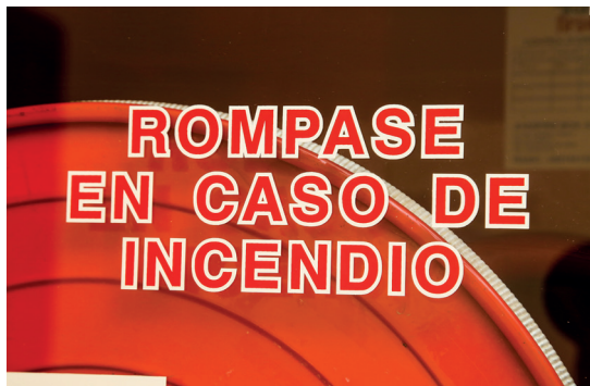
Boca d'incendis amb material segur i de fàcil trencament per l'usuari
